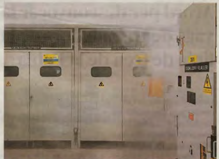
FOTO_ Endesa Sala de la central del Pont de Suert
