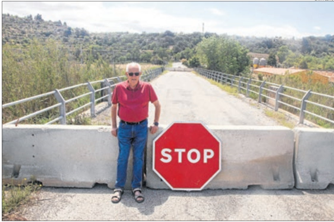
Josep Balsells mostra les peces de formigó que tallen el pas pel pont de l'antiga L-201.
