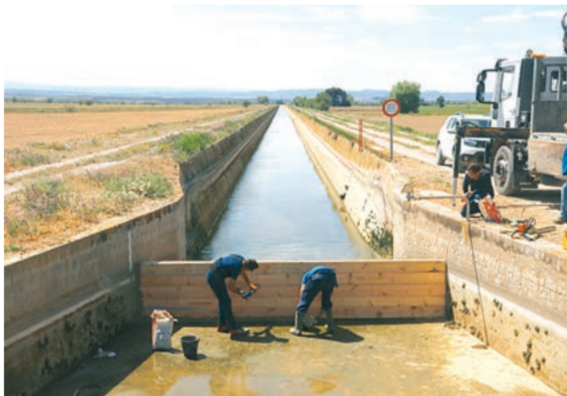
FOTO_ ACN Operaris construint una tanca per retenir l'aigua al canal d'Urgell
