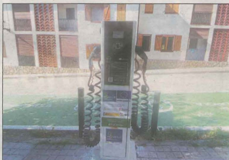
FOTO: Aj. T. Capdella / La instal·lació s'ha completat en nou mesos
