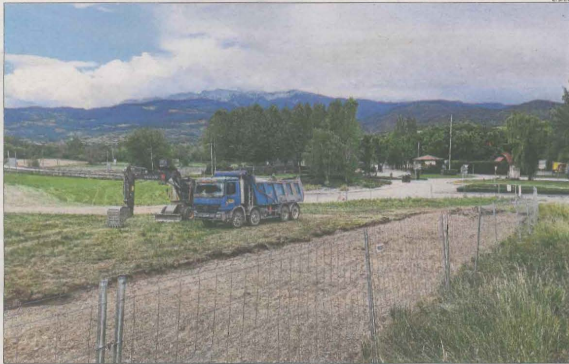
Imatge de les obres per urbanitzar els terrenys on es construiran les superfícies comercials.
