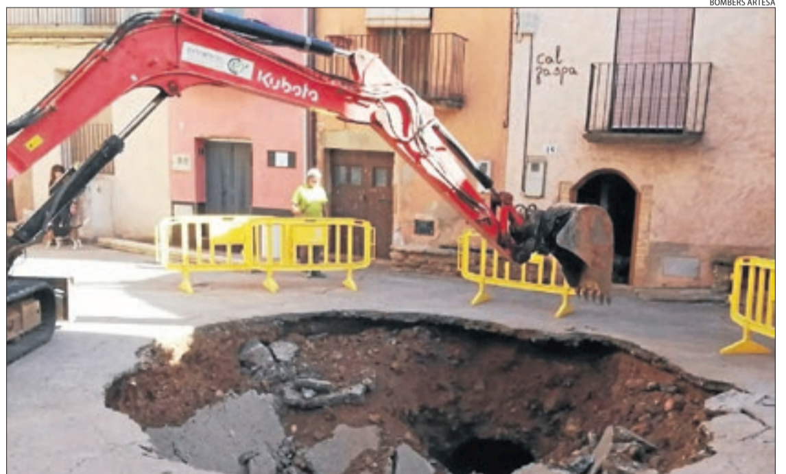
Una excavadora saneja l'entorn del clot que va 'engolir' dijous una furgoneta a Tudela de Segre.
