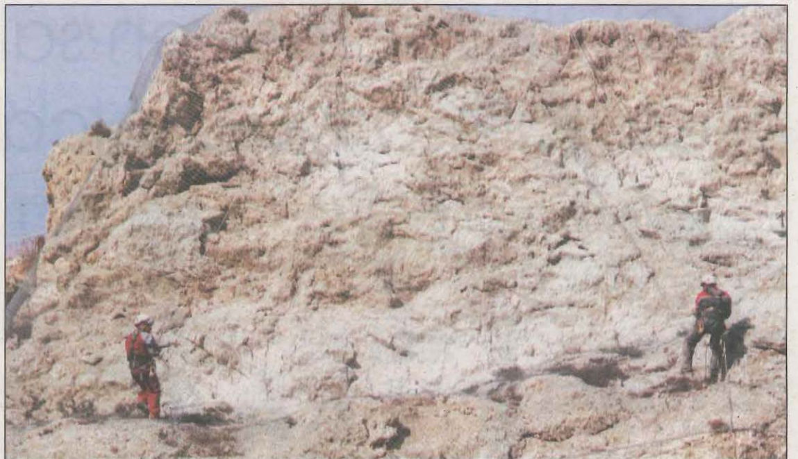
FOTO: Tony Alcántara/ Els tècnics col·locant ahir les malles a la Penya que perillava de caiguda
