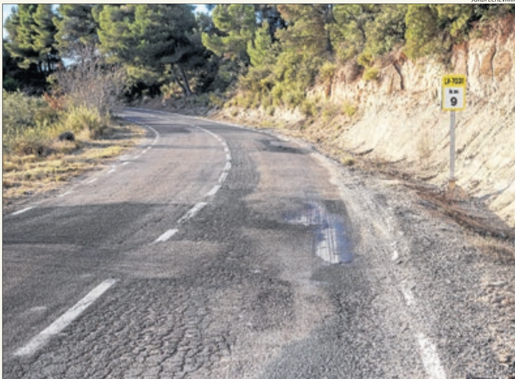
El tram de carretera de les Borges a Cervià pendent de reforma. El ferm està malmès.
