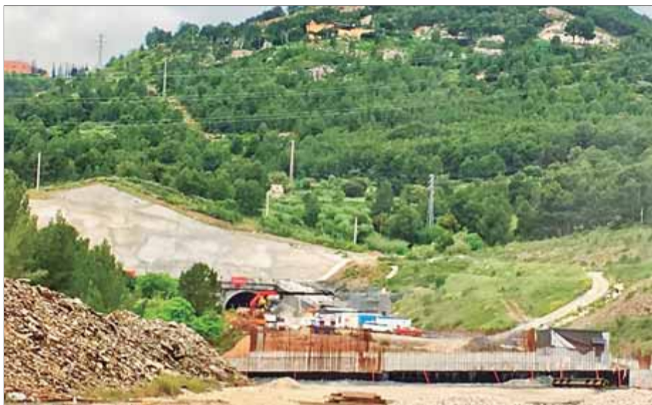
Treballs al túnel del coll de Lilla de l'autovia A-27 entre Valls i Montblanc, el maig passat ■ ACN
