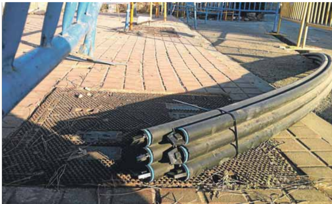
Obres per a una instal·lació de fibra òptica al Maresme ■ ELENA FERRAN / ARXIU
