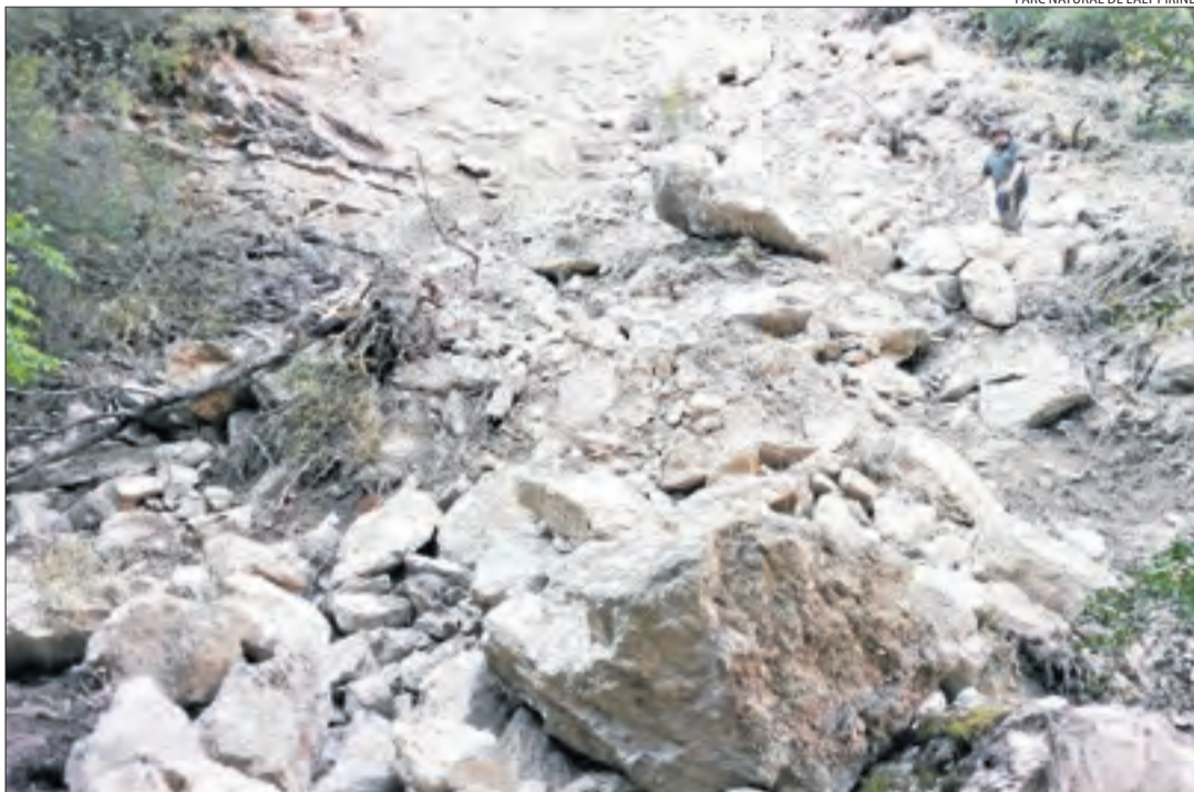
El sender que connectava Sort i Baro ha quedat completament tallat a causa de l'allau.
