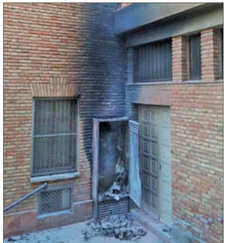
FOTO: Bombers / Imatge d'un quadre elèctric apagat a Lleida
