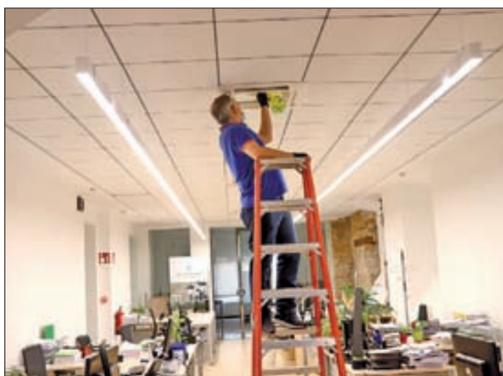
FOTO: Diputació / L'actuació se centra en els equips de climatització
