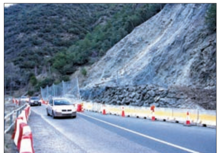
FOTO: Albert Lijarcio (ACN) / Foto d'arxiu del lloc dels despreniments
