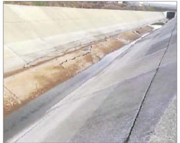
Les esquerdes al canal principal del Segarra-Garrigues a Verdú.
