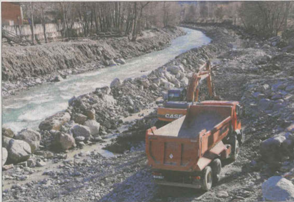
Imatge d'arxiu de les obres que es porten a terme al canal de piragüisme de Sort.
