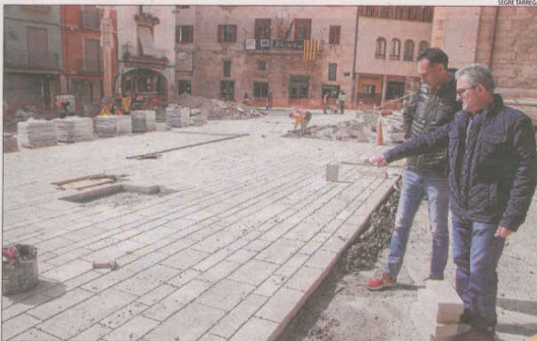
La visita d'obres als treballs per reformar la plaça Major de Tàrrega.
