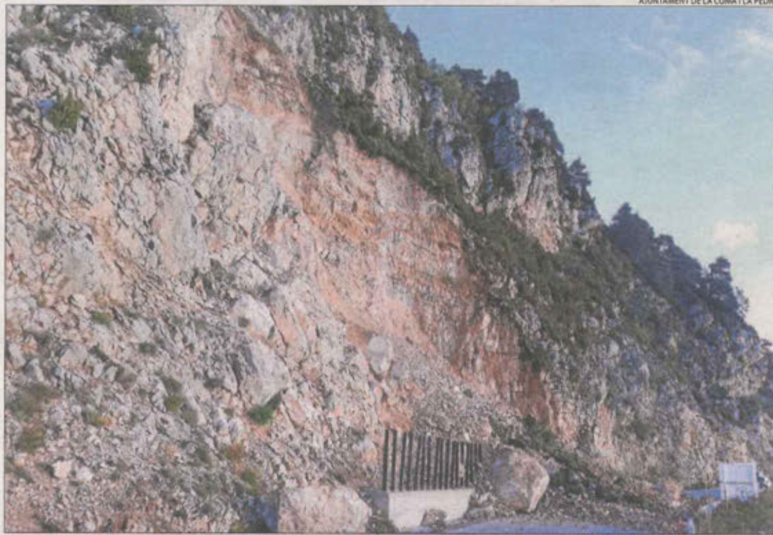
El desprendiment a la carretera de Coll de Jou, que continua tallada després de nou dies.
