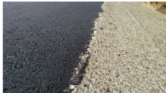
Detall de la trobada del nou paviment d'aglomerat en calent amb la cuneta de formigó
