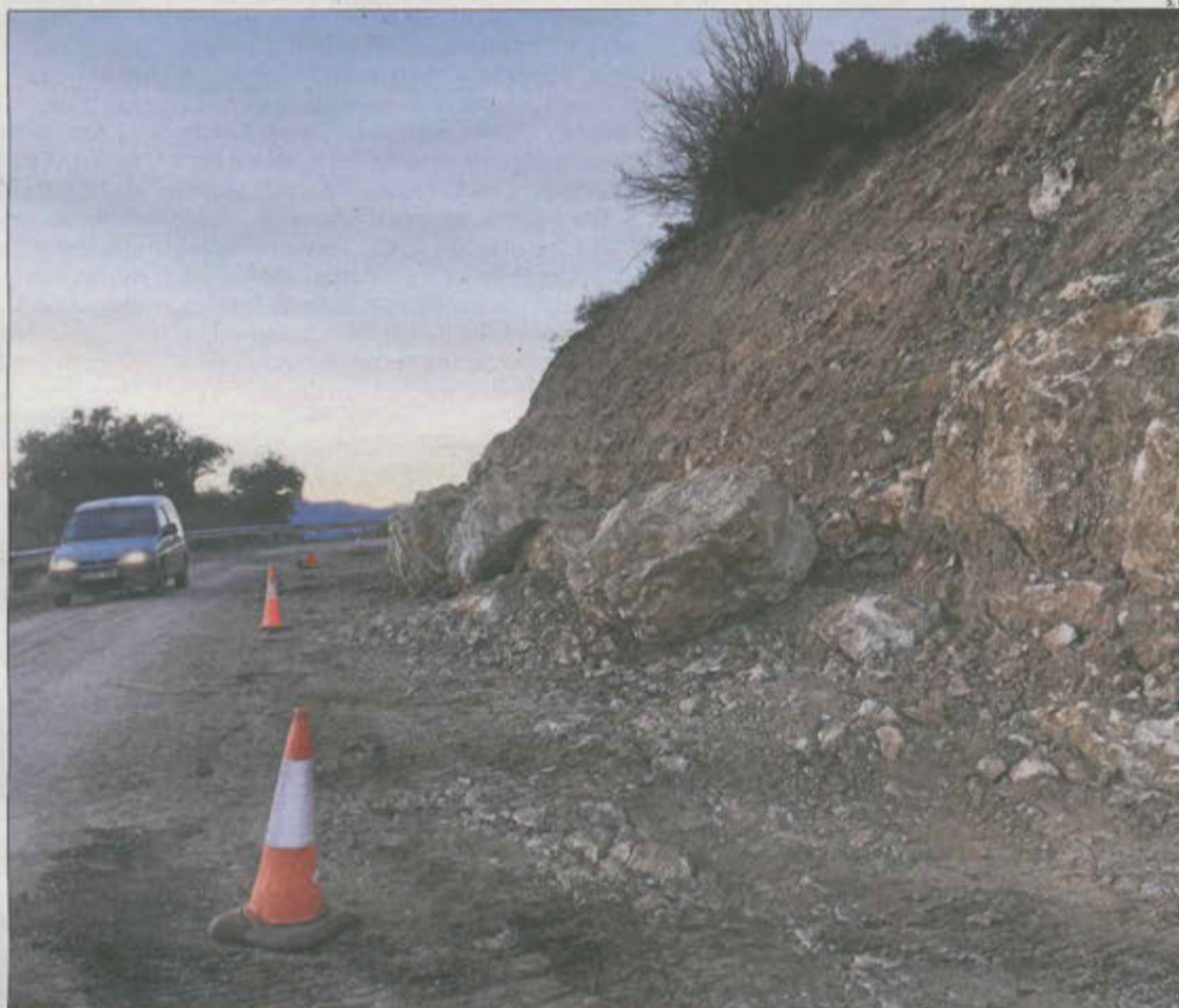
La carretera d'accés a Llimiana, parcialment afectada per despreniments recents.
