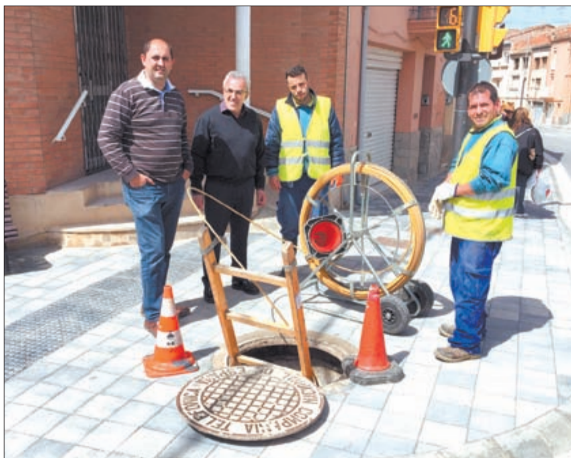
FOTO: ACN / Instal·lació de fibra òptica a les Borges (en foto d'arxiu) desplegada a través d'operadors privats
